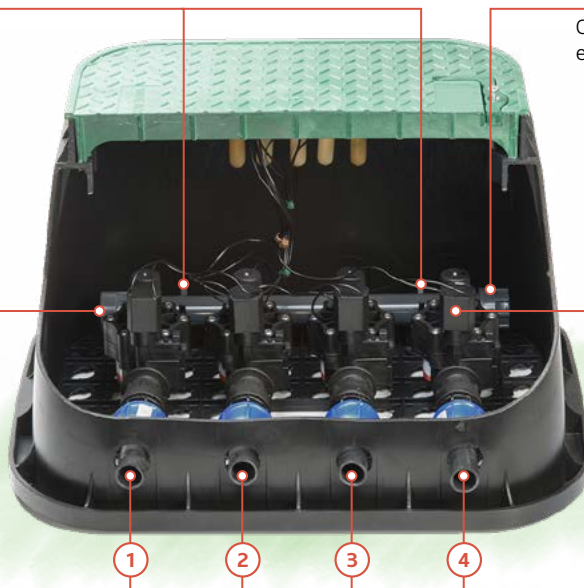
Ligação das eletroválvulas aos setores de rega
